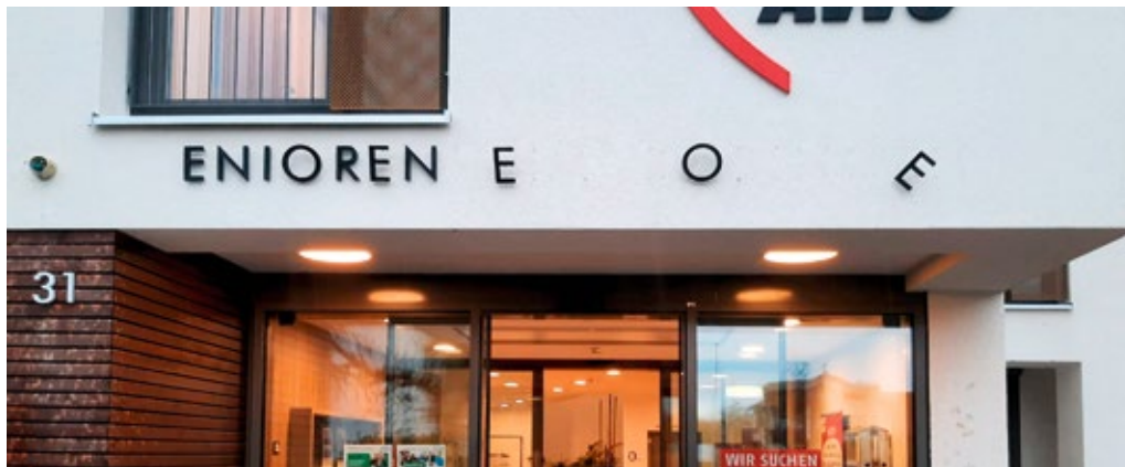
Hagel verursachte Schäden an Gebäuden, wie hier am Seniorenheim Bobingen.
